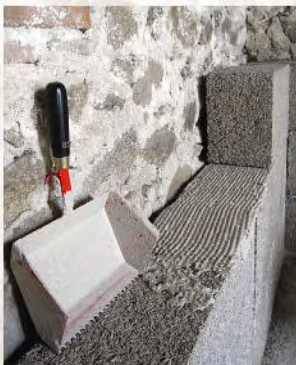
pose de blocs de chanvre en isolation intérieure d'un mur en pierres
